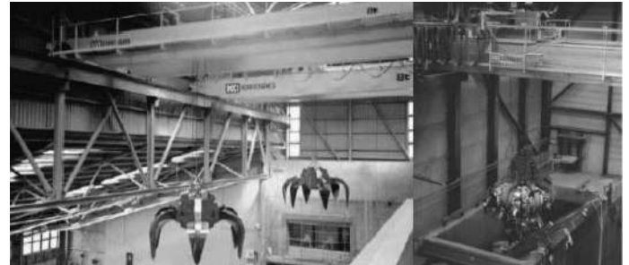
Слика 6.26. Изглед крана са граблицом за отпад
