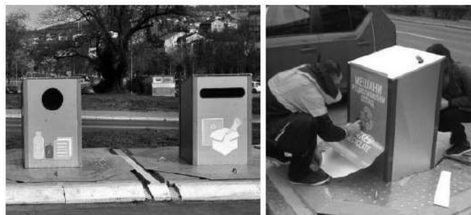
Слика 6.12. Пример постављених подземних контејнера од 3 м 3 за сакупљање рециклабилног отпада у Београду
