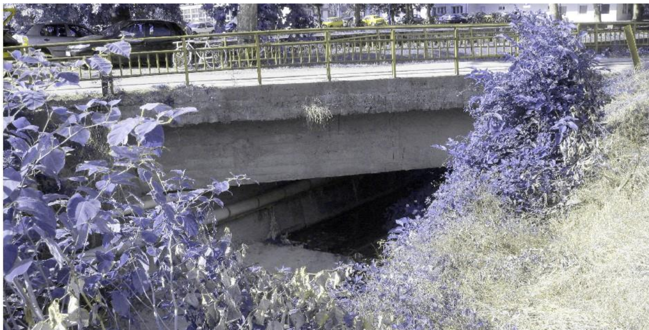
Слика 9. Јездинска Лупњача, пропуст ID:RPMLu5 (недовољан протицајни профил мостовског пропуста)
