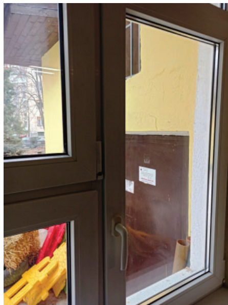
Слика 8. Детаљ новоуграђених ПВЦ прозора
