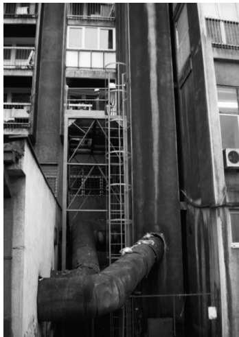
Слика 4.6. Улаз димљача котлова у бетонски емитер
