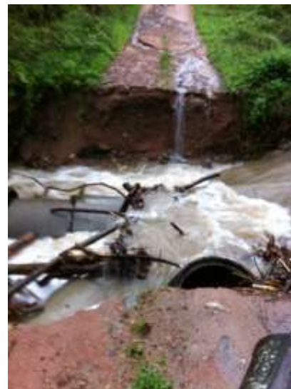
Урушен пропуст на Селачкој реци
