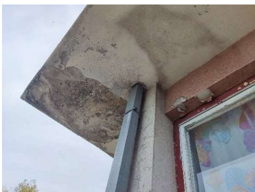
Слика 0.3 - Оштећење стрехе
