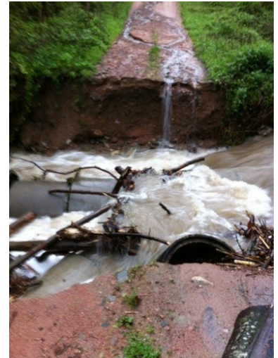
Урушен пропуст на Селачкој реци
